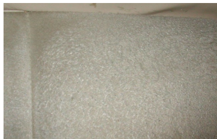
Het oppervlak is compleet vervilt. Zulke delen zijn niet meer te redden.
